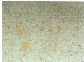
空気が混入して内面がさびた容器内面
