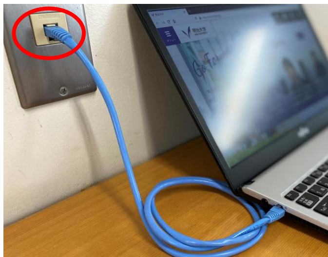
(図 1-1) LAN ケーブルの接続
