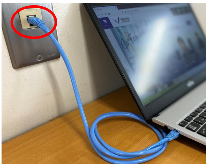
(図 1-1-1) LAN ケーブルの接続
